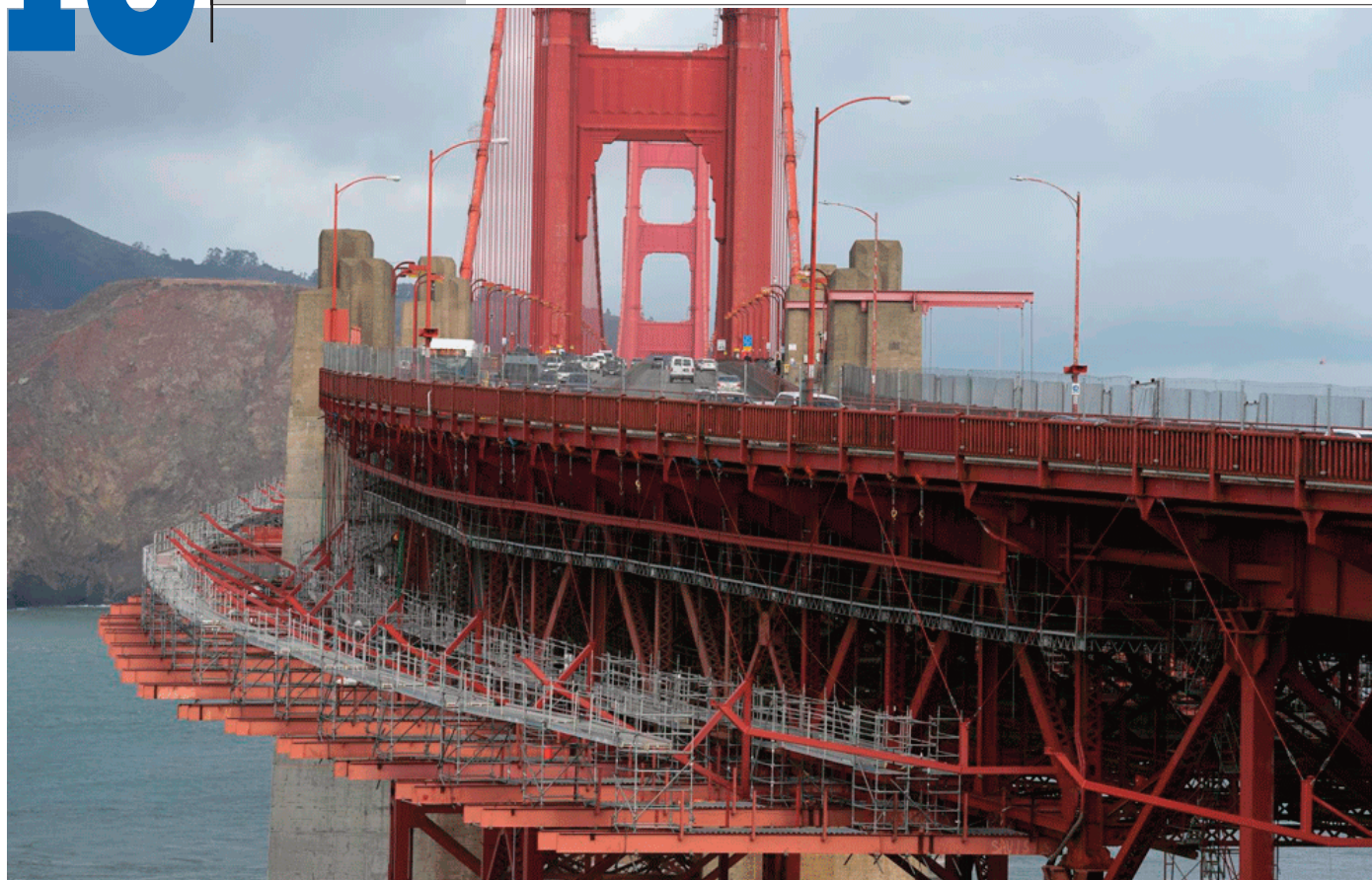
Vista de una red de disuasión de suicidios en construcción en el puente Golden Gate de San Francisco, miércoles 6 de diciembre de 2023.
