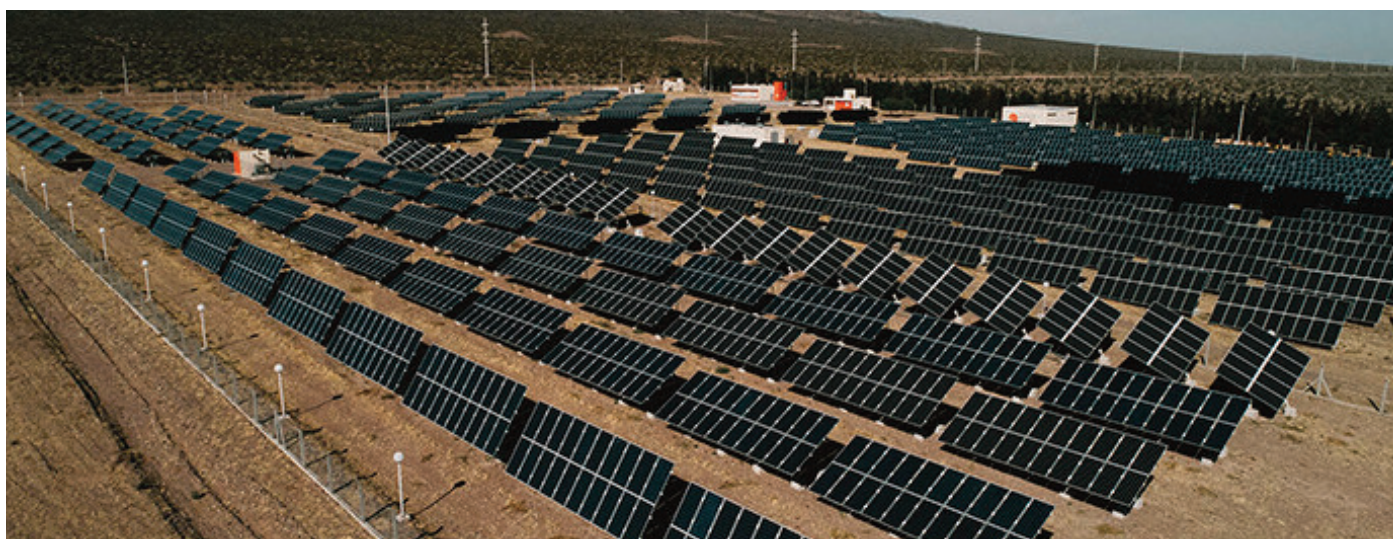
Parques de energía renovables (Planta fotovoltaica Ullum 1)
