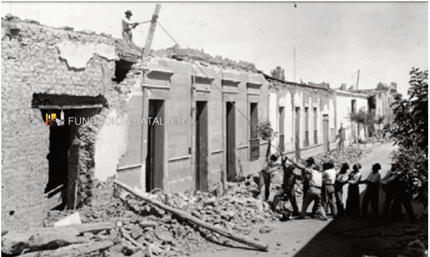
Oberos y voluntarios apuntalando los frentes destruidos.
